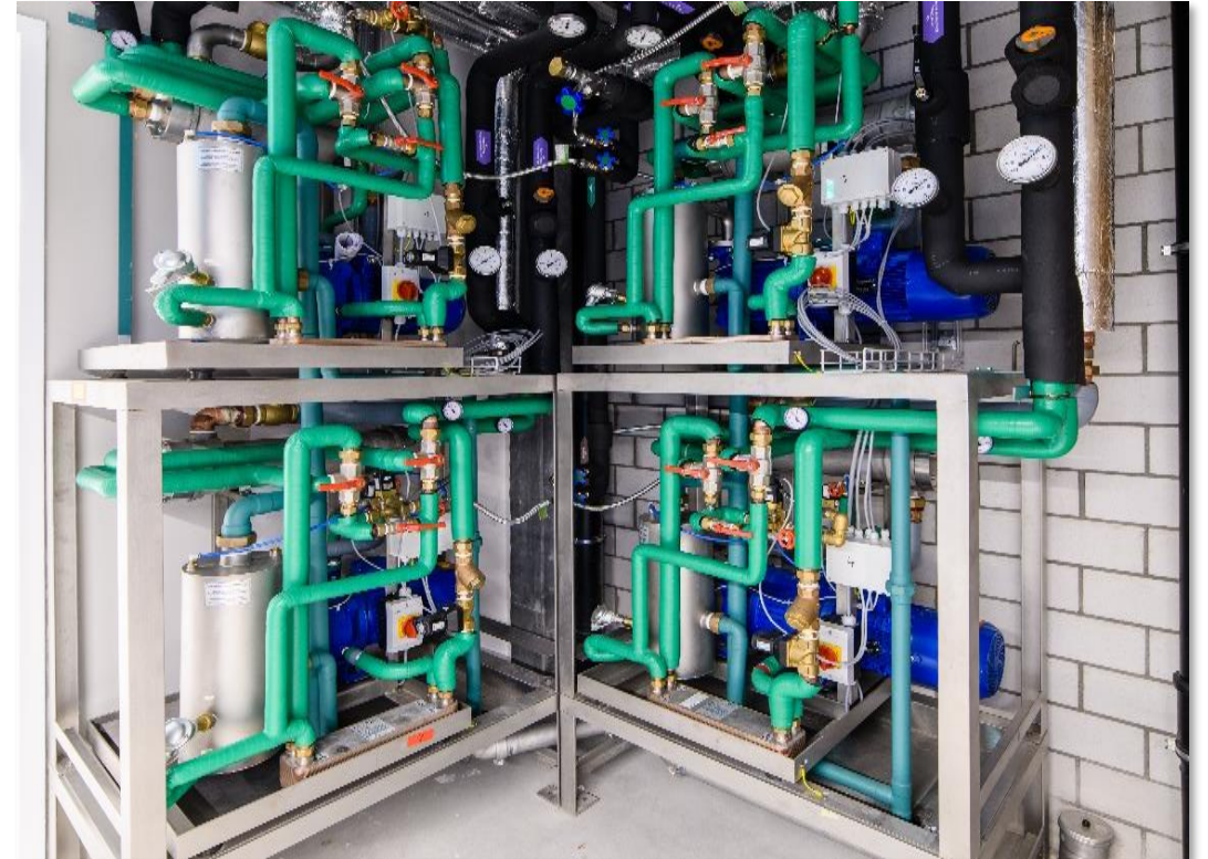
Dezentrale Aufstellung Vakuumpumpen
